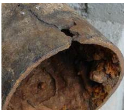
Figura 3 - Fissuras e furos pontuais na parede da tubulação. (Fonte: Sabesp/MCEA)
